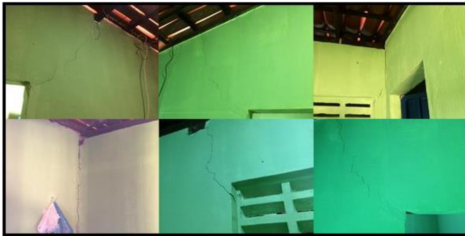
Figura 25 – Casa danificada na Comunidade Quilombola de Santana/PE
