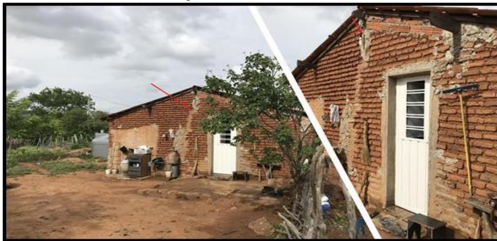
Figura 24 – Danos causados à estrutura de uma das casas da Comunidade Quilombola de Santana/PE
